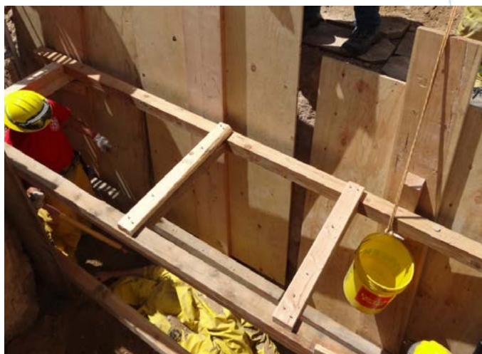
Figura 5 - Parede com pranchas de madeira escorada através de WALER SYSTEMS® da Speed Shore Inc.
