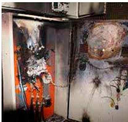
I - Descarga em um quadro de eletricidade
